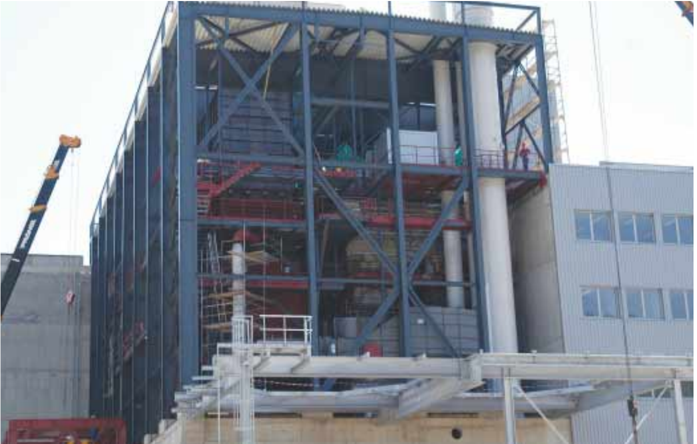
Thermische Reststoffverwertungsanlage Niklasdorf
