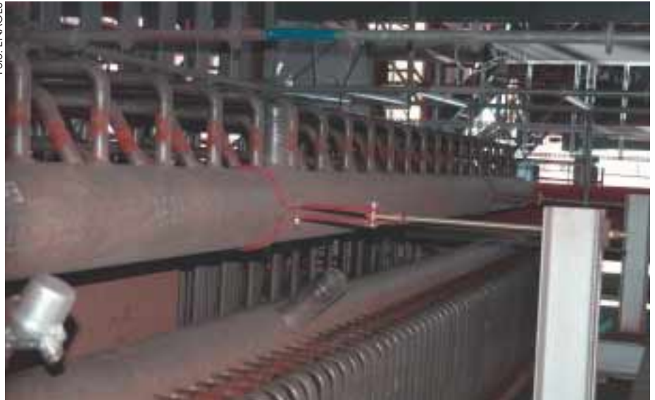
Das „Innenleben“ der TRV Niklasdorf (hier ein Sammelrohr) ist schon weitgehend fertig.
