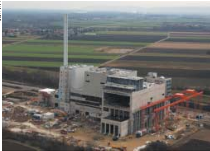
Stellt das Rückgrat der Umsetzung der Deponie-Verordnung dar: die thermischen Abfallbehandlungsanlagen, wie z. B. die AVN-Anlage in Zwentendorf/Dürnröhr (NÖ).
